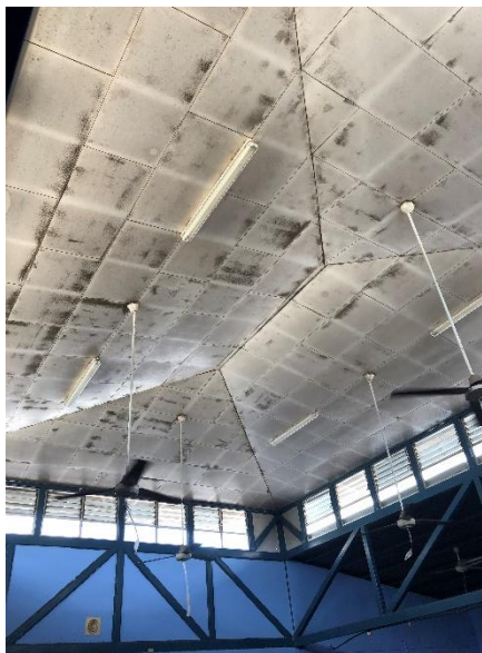
Fotografía 11: Sede de Área Cielo percutido y cubierta oxidada.
