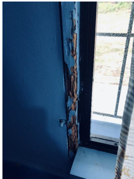
Fotografía 30: Elementos de madera deteriorados por acción de termitas (puertas, marcos de ventana, paredes).
