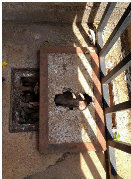
Fotografía 12: EBAIS Santa Rita Caja de registro: tubería expuesta y tapa deteriorada.
