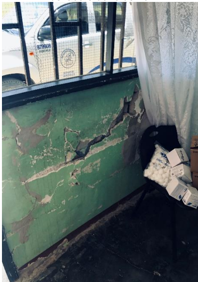
Fotografía 17: EBAIS La Llorona Paredes con grietas y orificios con exposición del acero de refuerzo.
