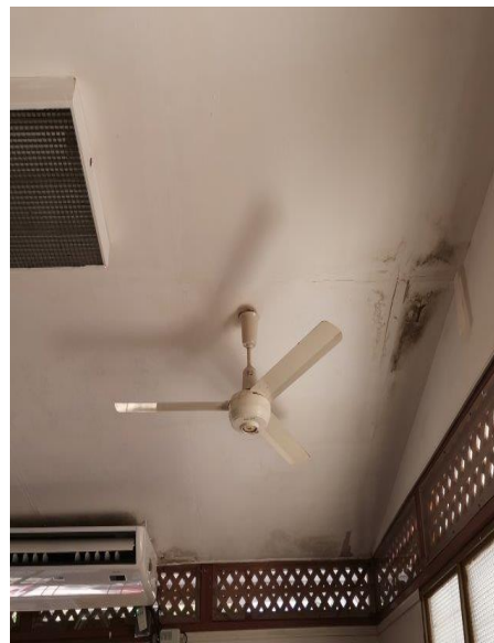
Fotografía 2: EBAIS Fray Casiano Cielos deteriorados por humedad
