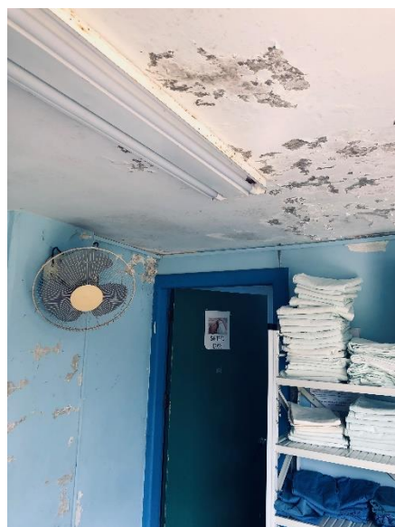
Fotografía 32: Consultorios Parades y cielos con acabado de pintura deficiente (presencia de humedad)
