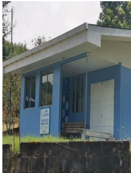
Fotografía 10: PVP Zapotal Ausencia de elementos seguridad y botaguas.
