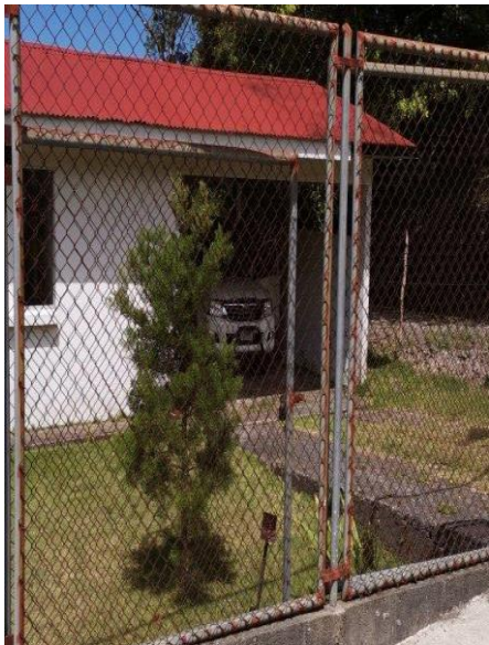
Fotografía 9: PVP Palmital Malla Perimetral oxidada.
