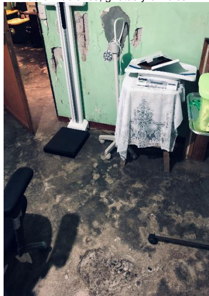
Fotografía 18: EBAIS La Llorona Contrapiso deteriorado con acabado deficiente: deformaciones, grietas y orificios.
