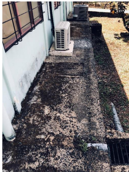
Fotografía 20: PVP El Silencio Aceras deterioradas: presencia de moho y desgaste de la superficie de concreto (irregular).
