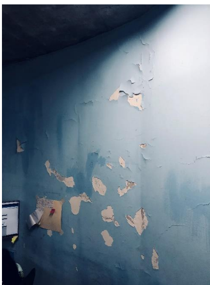
Fotografía 31: Consultorios Paredes con acabado de pintura deficiente
