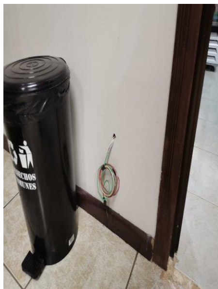
Fotografía 3: EBAIS Fray Casiano Cables eléctricos expuestos y falta de plaquería
