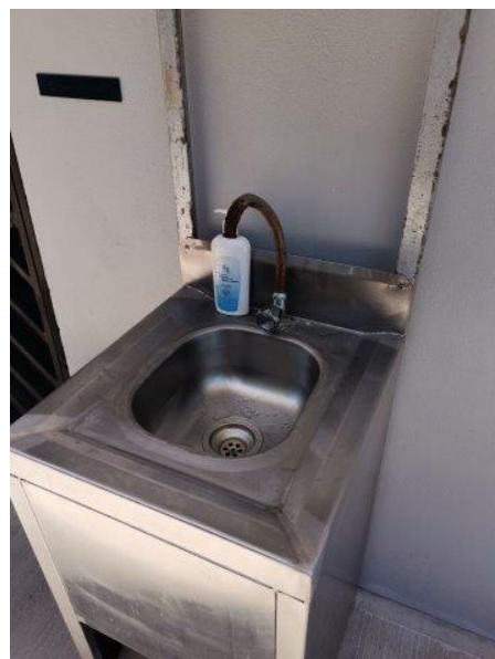
Fotografía 4: EBAIS Eduviges Mobiliario oxidado
