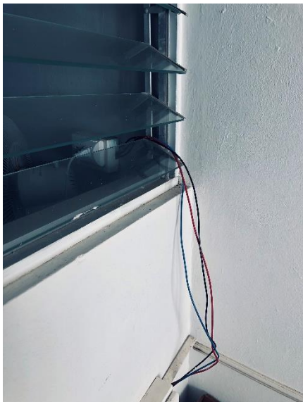
Fotografía 29: PVP Esterillos Cables eléctricos expuestos sin entubar.
