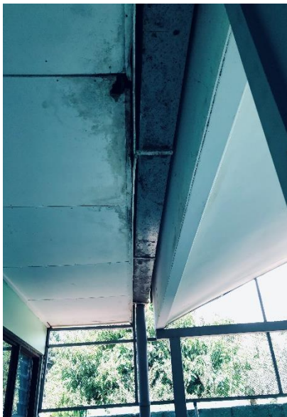
Fotografía 19: EBAIS Mata Palo Cielorraso deteriorado y percutido. Canoa interna oxidada.
