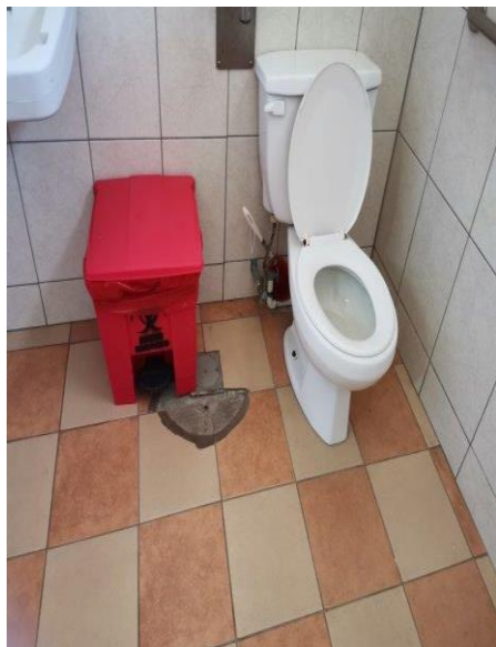
Fotografía 1: EBAIS Chagüite Piso fracturado y carencia de accesibilidad
