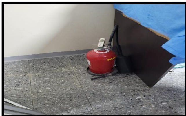
Imagen 15 Extintor en el suelo, sin señalización ni distinción de su tipo.
