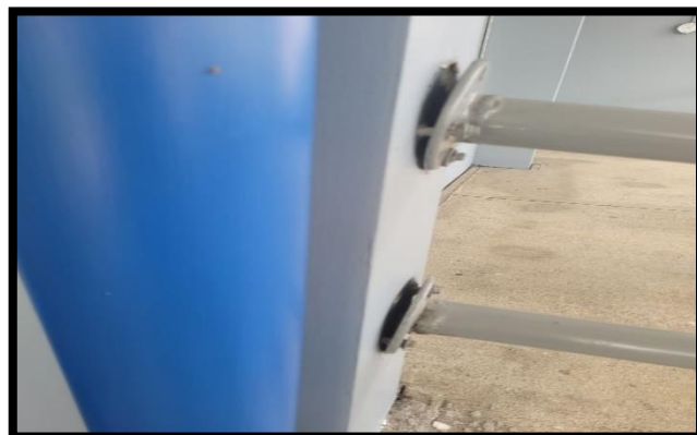
Imagen 16 Tornillos sueltos de barandas
