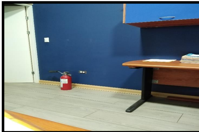
Imagen 33 Extintor sin rotulación y colocación adecuada
