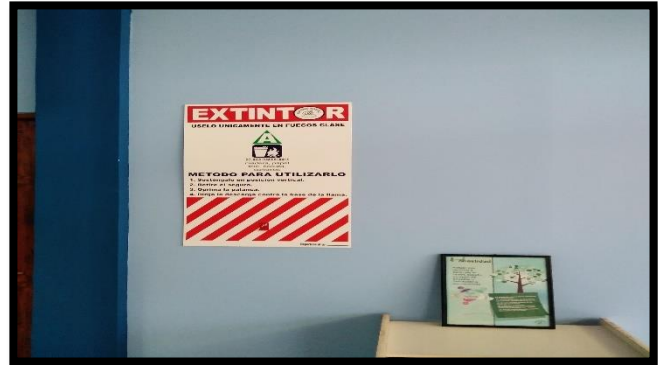
Imagen 31 Área con ausencia de extintor.
