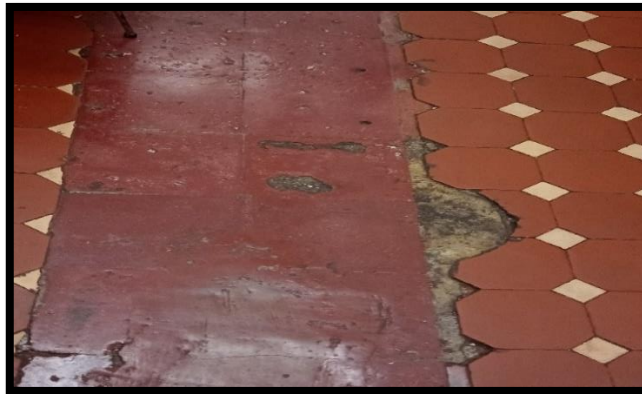
Imagen 14 Pasillos del edificio Chapuí en mal estado
