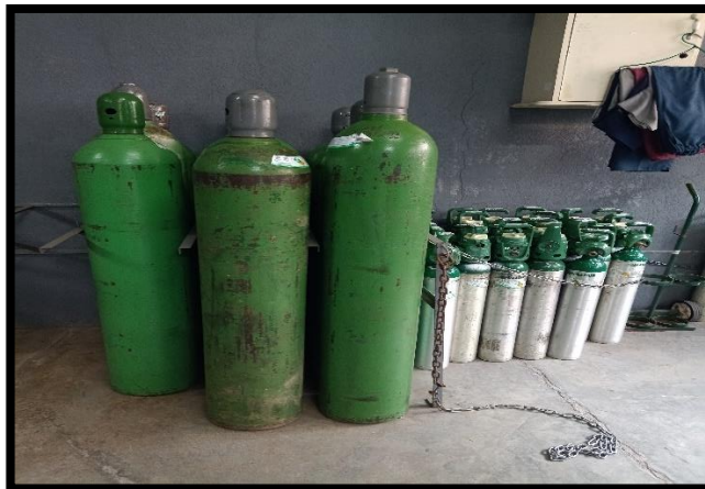
Imagen 9 Caseta de gases medicinales estaba sin el personal de atención y abierto adicionalmente, tanques de gases sin amarrar
