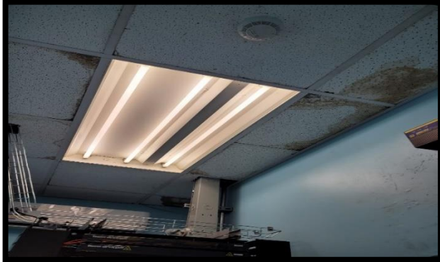
Cielo raso con señales de humedad
