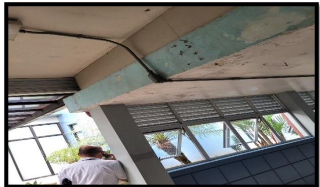
Desprendimiento de pintura en los techos
