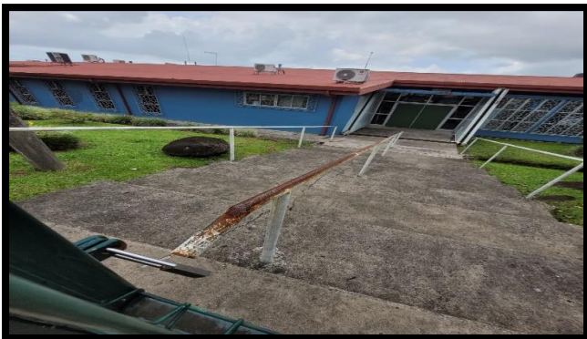
Baranda con señales de herrumbre
