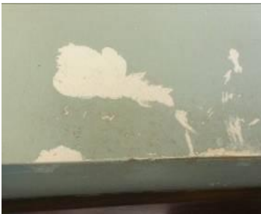
Clínica de úlceras, con daños en la pintura
