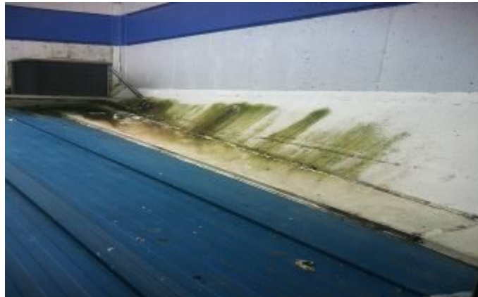
Paredes con presencia del hongos por humedad
