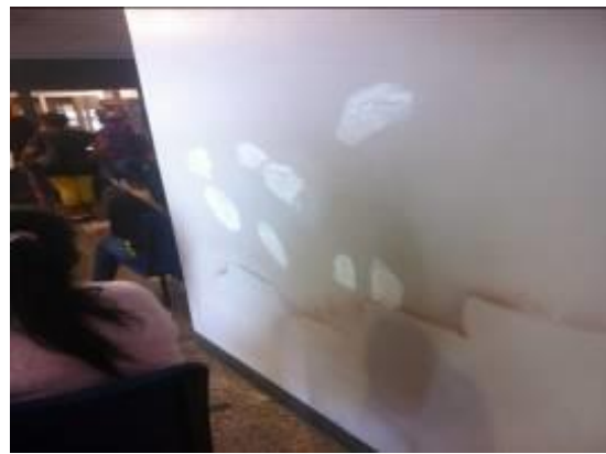
Servicio de farmacia, pintura deteriorada
