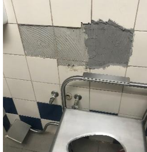
Fotografía #9: Enchape de servicios sanitarios de observación neurocirugías mujeres en el 3 piso.
