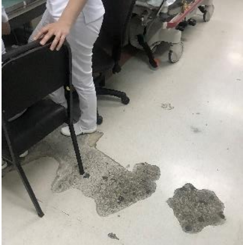
Fotografía #2: Piso de estación de enfermeras en consultorios de emergencia en primer piso.
