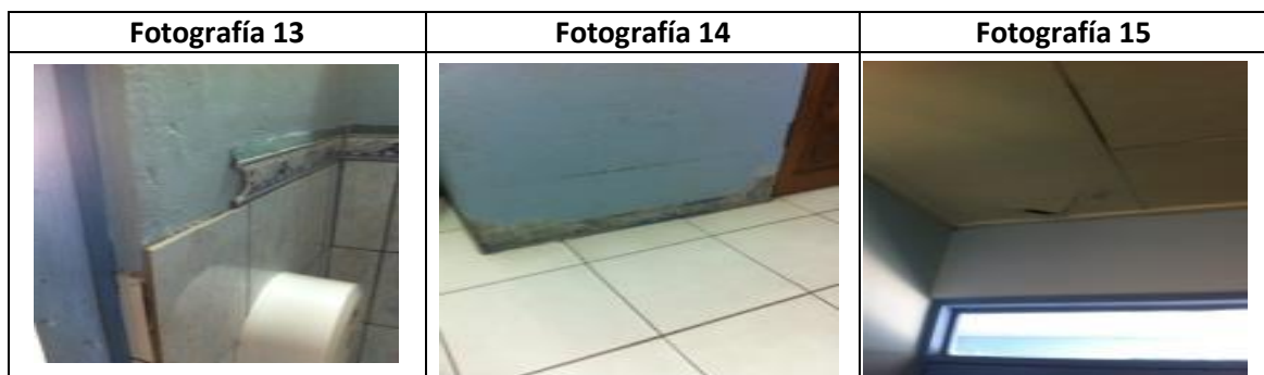
Paredes del servicio sanitario en mal estado – Paredes del pasillo deterioradas – cielos dañados
