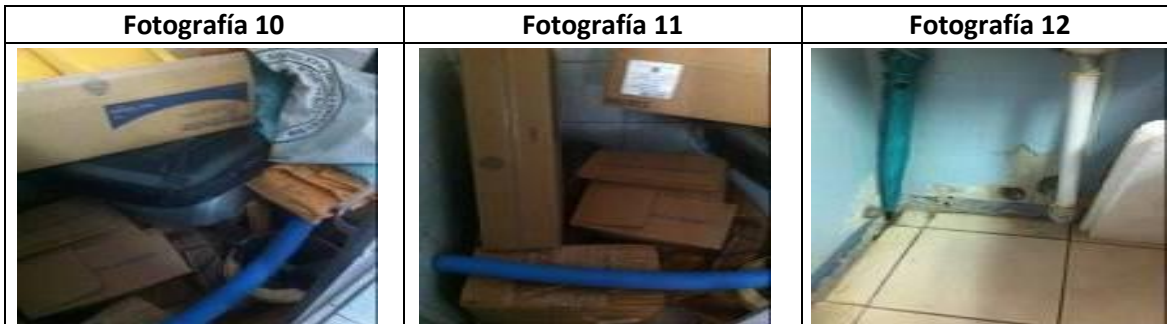
Materiales de desecho y mercaderías en buen estado en área de ducha – debajo de lavatorio daños en pared, los bajantes de lavatorios no tienen sifón
