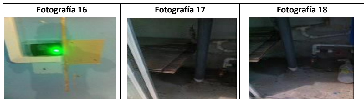
Comedor empleados, piezas del cielo deterioradas - Madera dañada debajo del fregadero por fuga de agua
