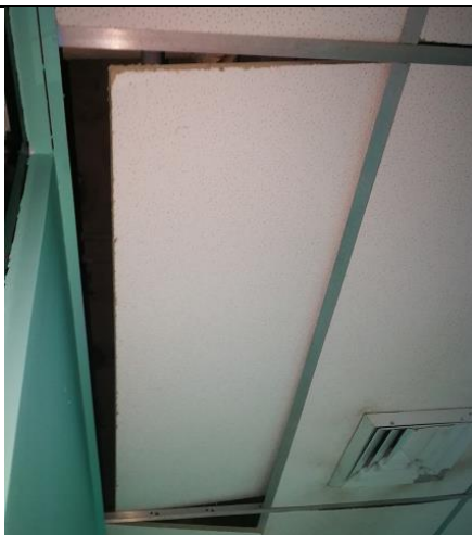
Foto 39 – Daño en cielorraso
