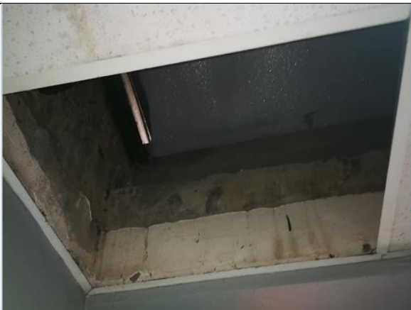
Foto 16 – Falta cielorraso baños
