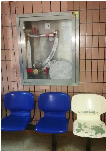
Foto 35 – Obstrucción al acceso sistema contra incendios
