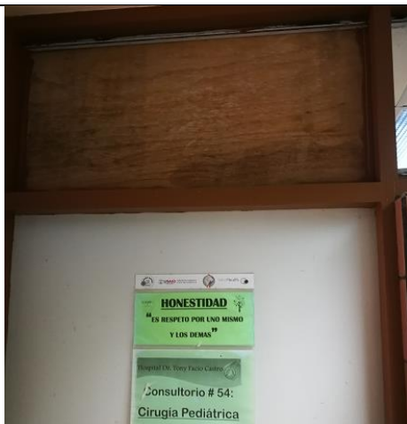
Foto 7 – Tabla tapando abertura sobre puerta en Cirugía pediátrica.
