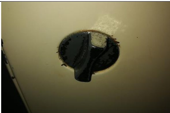
Foto 14 – Llavines de puerta de servicios sanitarios dañadas
