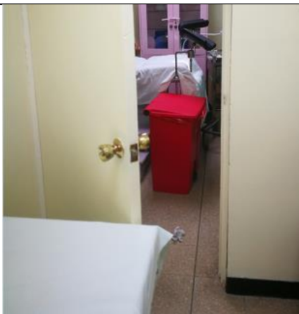
Foto 23 – Puerta de ingreso a monitoreo ginecología choca con camilla y no se puede abrir.
