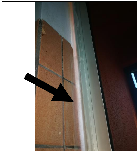
Foto 44 – Marco de ventana en Consulta Externa.
