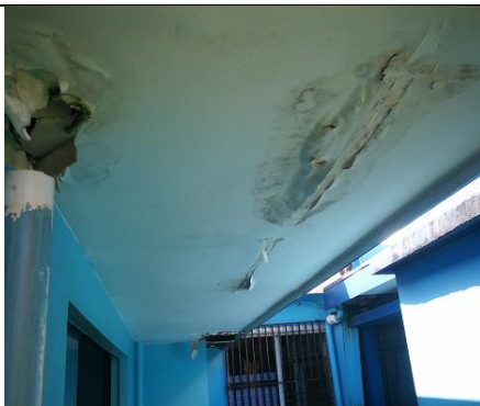
Foto 31 – Problemas de cielorraso
