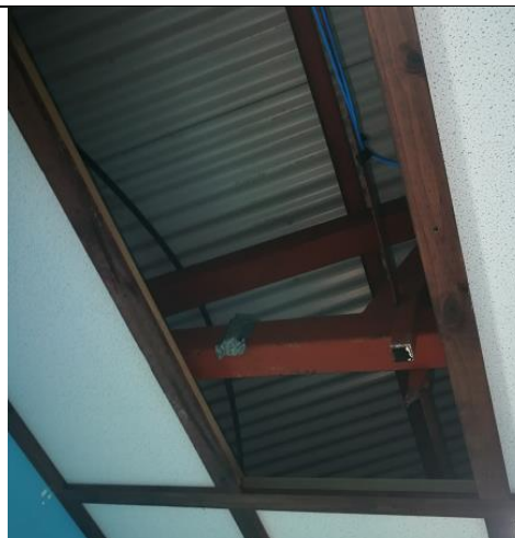
Foto 28 – Falta de láminas de cielorraso
