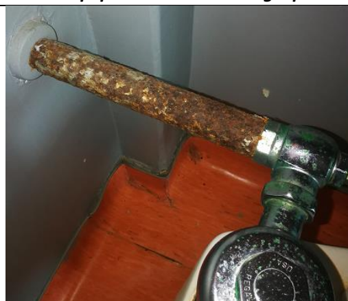
Foto 11 – Daño en servicio sanitario tubo de abasto
