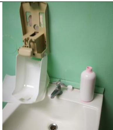
Foto 24 – Dispensadores dañados y sin jabón
