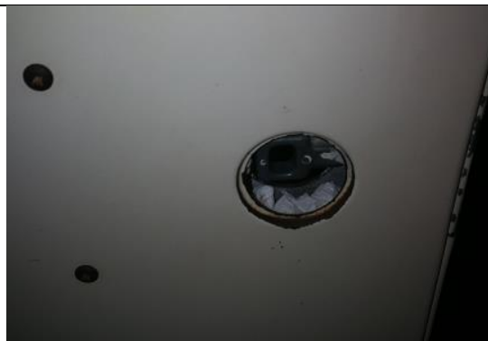
Foto 13 – Llavines de puerta de servicios sanitarios dañadas
