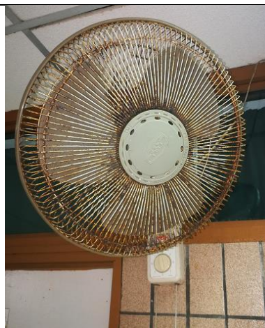
Foto 43 – Ventiladores en mal estado
