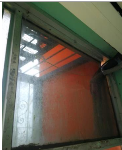
Foto 20 – Ventanas de ginecología mohosas
