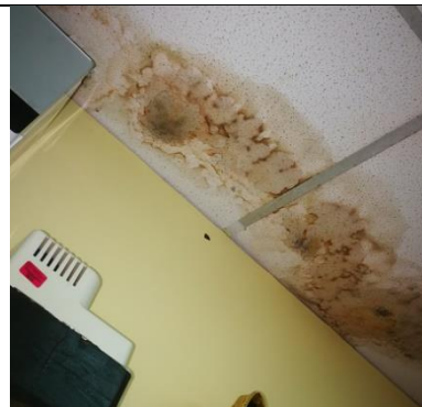
Foto 32 – Problemas de cielorraso
