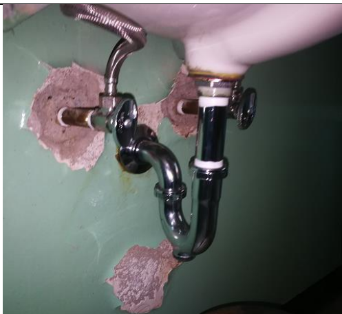
Foto 12 – Daño en paredes por instalación de lavamanos.
