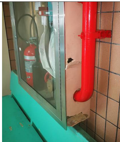
Foto 19 – Sillas obstruyen acceso a sistema contra incendio y caja dañada
