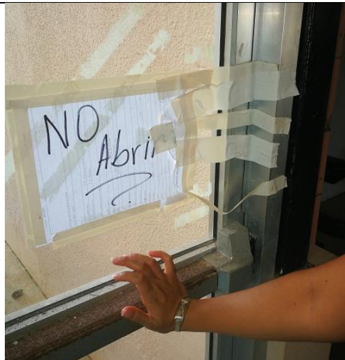
Foto 36 – Daño en puerta de salida emergencias
