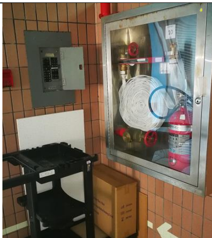
Foto 27 – Bloqueo acceso sistema contra incendios
