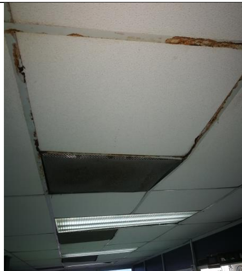
Foto 15 – Cielorraso dañado de plataforma
