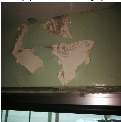
Foto 11 – Pared dañada de sala de espera
