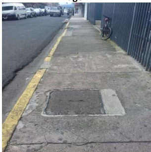
Acera superficie irregular
