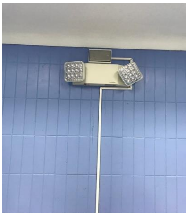
Foto 7. Lámparas de emergencia en sala de operaciones
