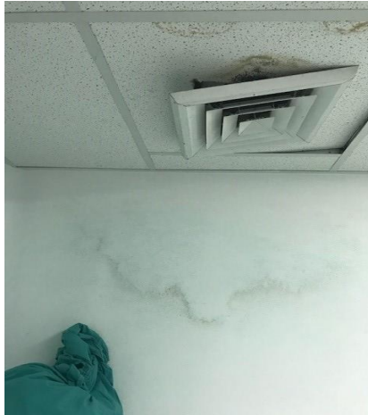
Foto 5. Filtraciones y fugas en Área Almacenamiento de Ropa Estéril
