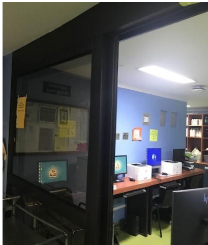
Foto 3. Puerta de Acceso al área semi restringida dañada
