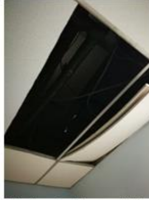
Foto 31 – Láminas de cielorrasos faltantes o por caer
