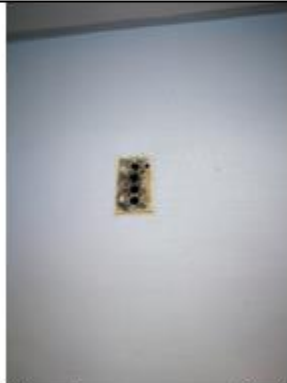
Foto 47 – Laminas expuestas, oxidadas donde aparentemente existió una luz
