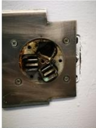
Foto 28 – Conexiones en malas condiciones.
