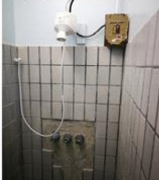
Foto 41 – Caja de break en ducha en mal estado
