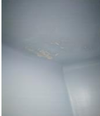
Foto 30 – Techos de quirófanos dañados
