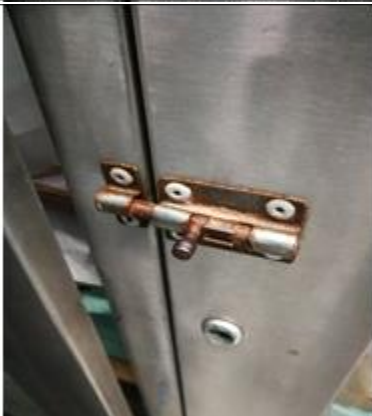
Foto 11 – Llavines dañados u oxidados
