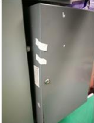
Foto 39 – Panel eléctrico en pasillo donde están usuarios previo ingreso sujetado con espadrapo
