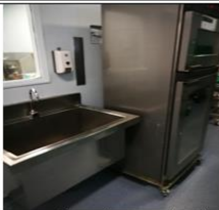
Foto 16 – Pila al abrir el chorro moja equipo calentador
