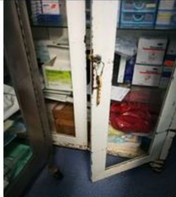
Foto 18 – Anaqueles en área estéril en mal estado
