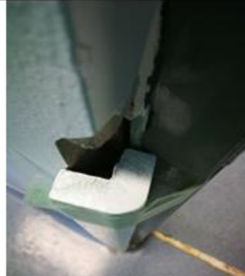
Foto 46 – Esquineros de quirófanos quebrados y sujetos con esparadrapo
