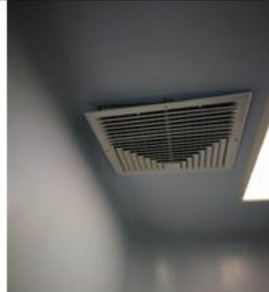
Foto 13 – Ventilas sueltas en quirófanos
