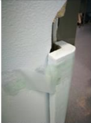
Foto 45 – Esquineros de quirófanos quebrados y sujetos con esparadrapo
