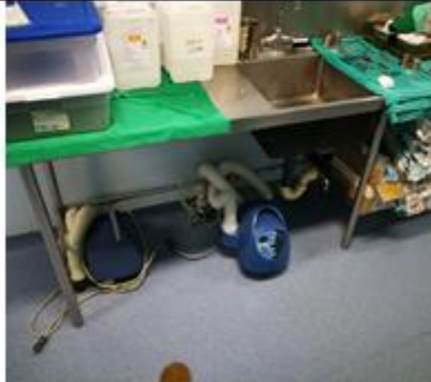
Foto 21 – Equipos en el suelo expuestos a los derrames de agua
