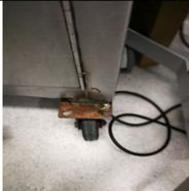
Foto 10 – Equipos con oxido en quirófanos
