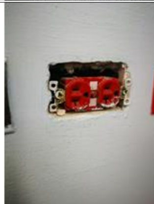
Foto 11 – Toma corrientes expuestas en los quirófanos
