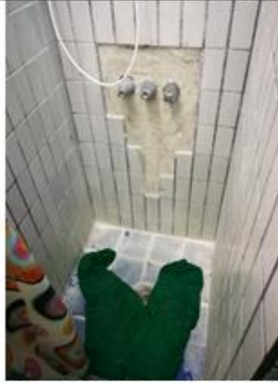
Foto 40 – Duchas en mal estado
