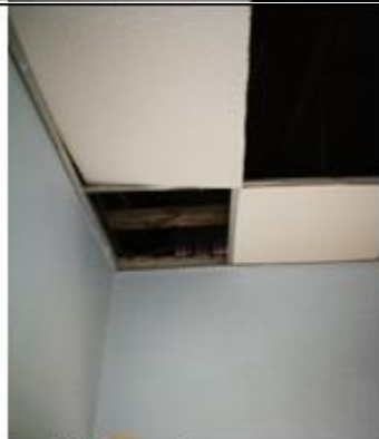
Foto 32 – Láminas de cielorrasos faltantes o por caer
