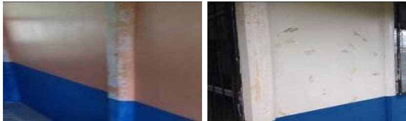
Desprendimientos de pintura en parte superior de paredes.
