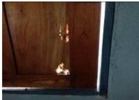
Ventanas deterioradas por comején.
