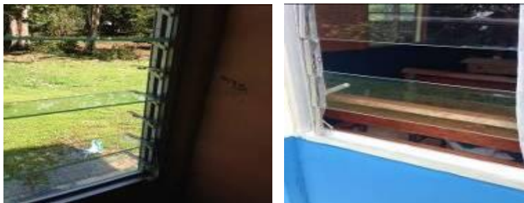
Faltantes de celosías
