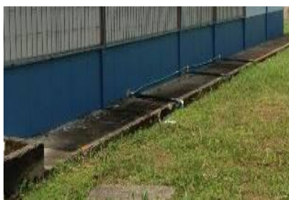
Aceras con exceso de hongos
