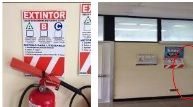
Los extintores deben estar debidamente instalados y señalizados.
