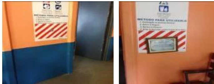
Ausencia de extintores
