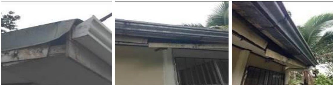
Precintas con herrumbre, hongos y suciedad. Desprendimientos en precintas
