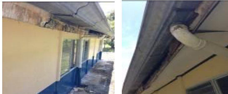
Precintas con hongos, descompuestas y desprendidas.
