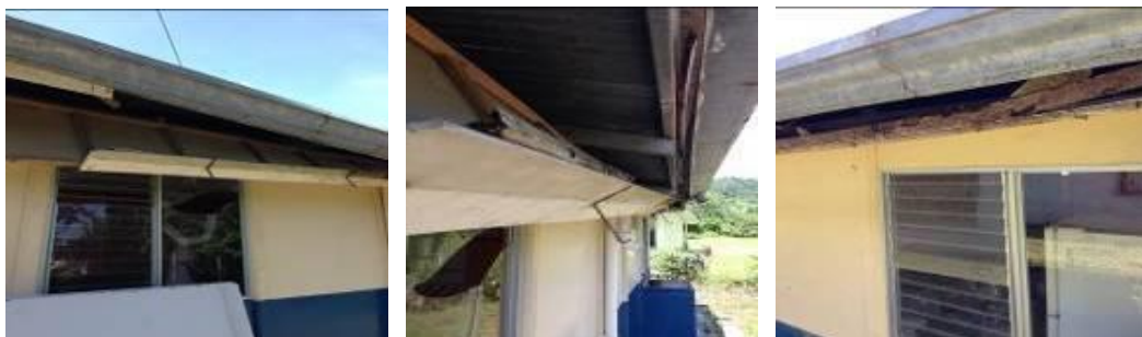
Cielo raso externo desprendido en varios sectores.
