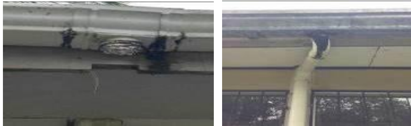
Carencia de bajantes, presencia de hongos y suciedad
