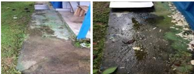
Aceras con vegetación, hongos y suciedad.
