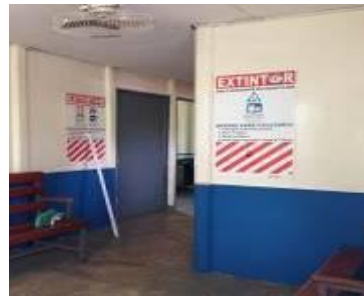
Carencia de Extintores
