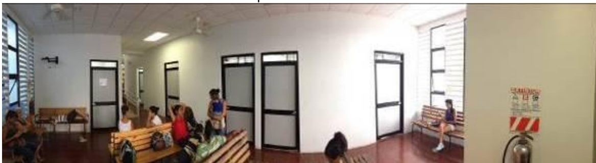
Ausencia de señalización respectiva de emergencias, Sala de espera, EBAIS de Puerto Jiménez
