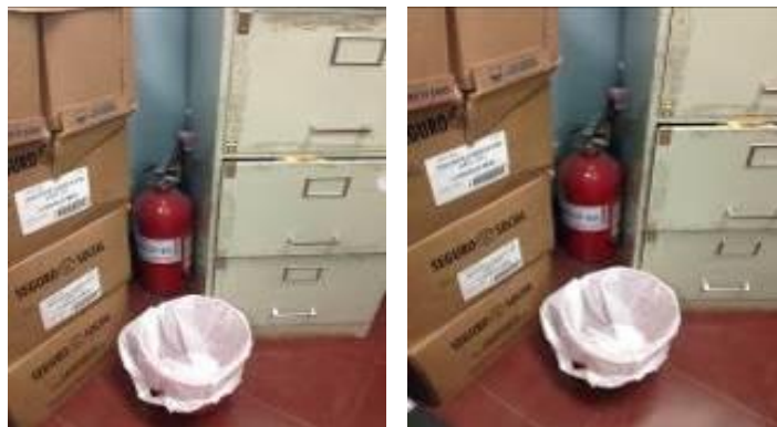
Extintores sin instalar, en sitio no visible, obstruido
