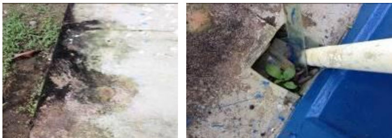
Bajantes obstruidos, hongos en acera.
