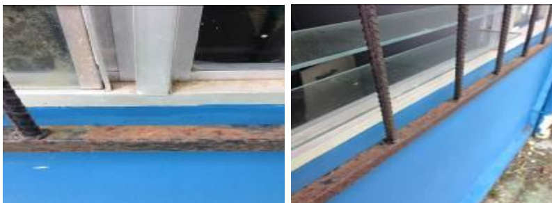
Verjas con exceso de herrumbre
