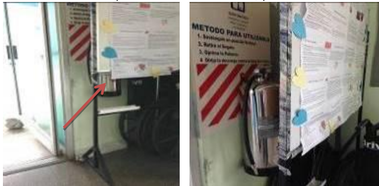
Los Extintores deben estar ubicados en un sitio visible, Acceso libre, sin barreras.
