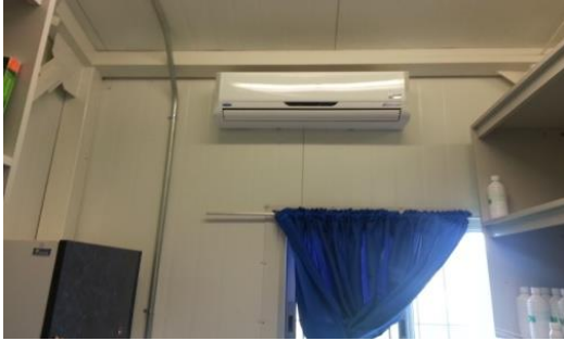
Aire acondicionado sin funcionar Farmacia
