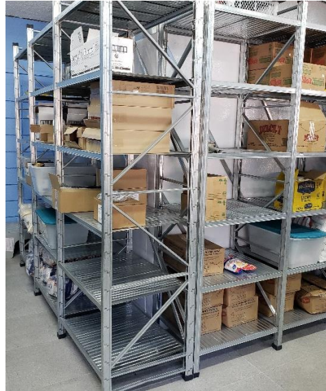
Ilustración 6. Bodega S.A.D. Nutrición. Los estantes no están sujetos al suelo o paredes con tornillos de alta resistencia.
