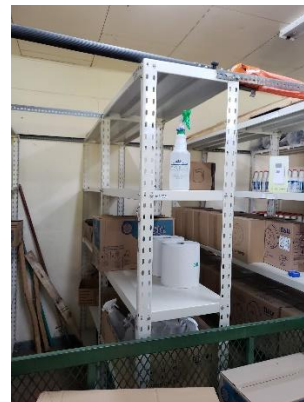
Ilustración 8. Bodega Satélite Aseo. Los estantes no están sujetos al suelo o paredes con tornillos de alta resistencia.
