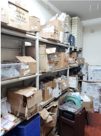
Ilustración 9. Bodega Satélite Nutrición. Los estantes no están sujetos al suelo o paredes con tornillos de alta resistencia.
