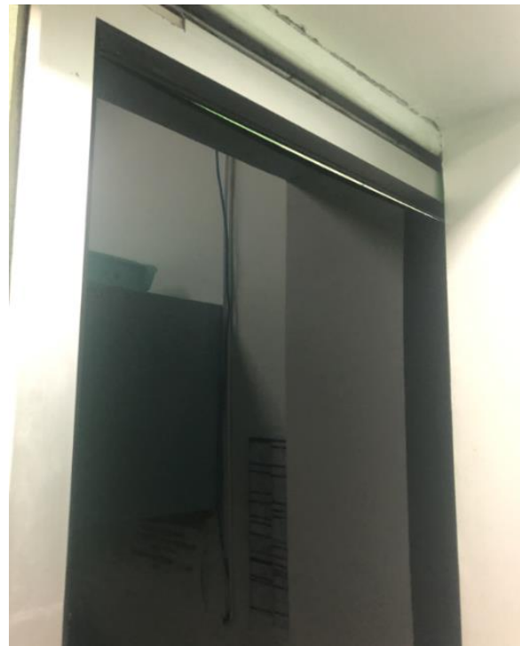
Fotografía #24: Puerta mal colocada
