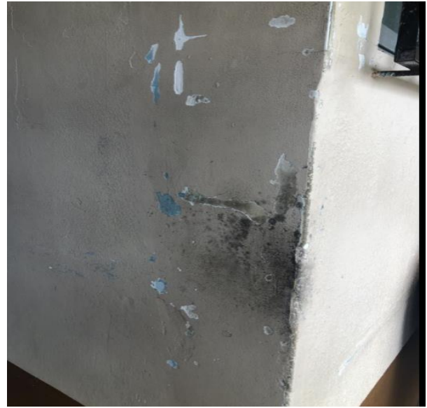
Fotografía #6: Pared con pintura deteriorada en la sala de espera
