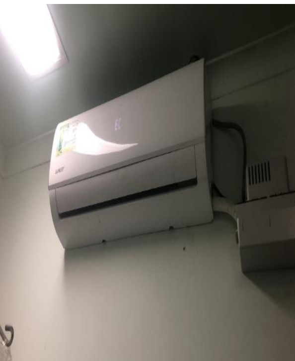
Fotografía #23: Aire acondicionado dañado
