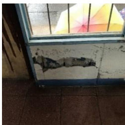
Imagen #21: Grieta en pared interna
