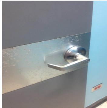
Foto #5 Llavín del Cuarto de Telecomunicaciones
