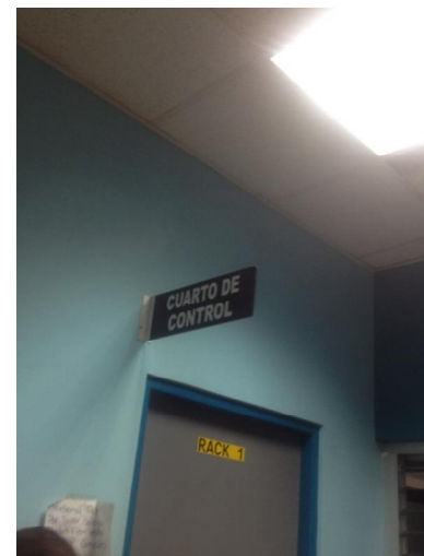
Foto #3 Cuarto de Telecomunicaciones
