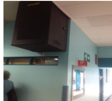
Foto #6 Rack aéreo
