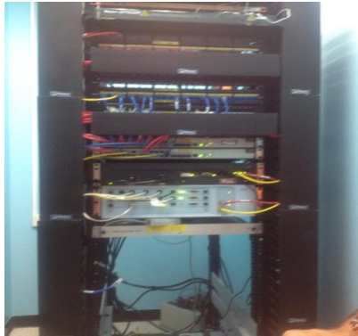
Foto #4 Cuarto de telecomunicaciones
