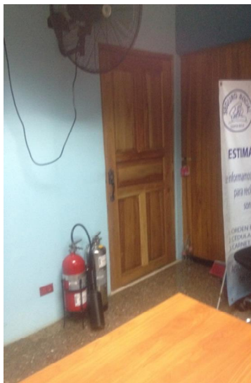
Foto #1 Cuarto principal de servidores
