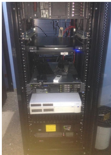
Foto #2 Cuarto principal de servidores
