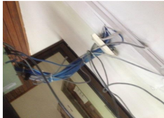
Fotografía 4: Cables de red Cuarto principal de telecomunicaciones
