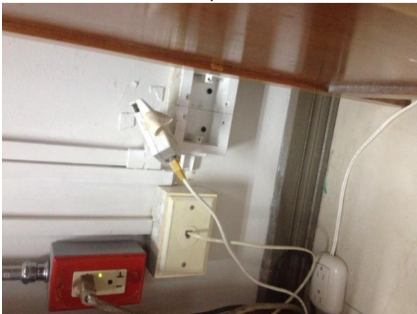
Fotografía 1: Puntos de red se desprenden de la pared
