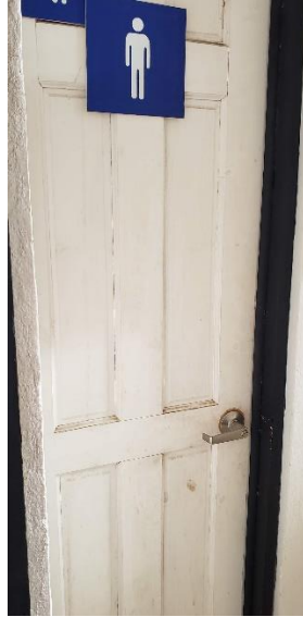
Ilustración 45. Puertas manchadas por la suciedad.
