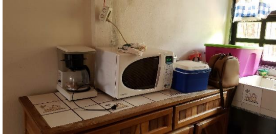
Ilustración 39. Cableada energizado sin tubería con infraestructura de madera.
