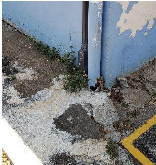
Ilustración 21. Bajante pluvial deteriorado.
