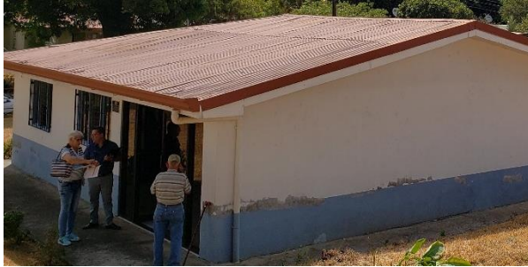
Ilustración 27. Pintura de paredes externas dañadas.
