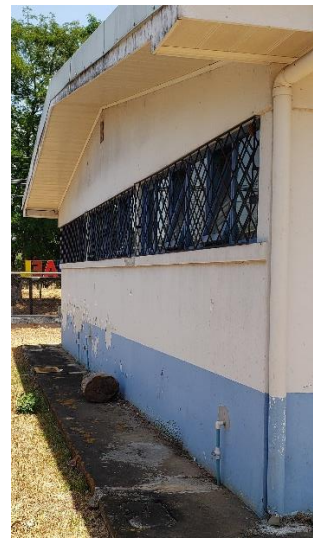
Ilustración 22. Paredes externas con pintura deteriorada y manchas en aleros.
