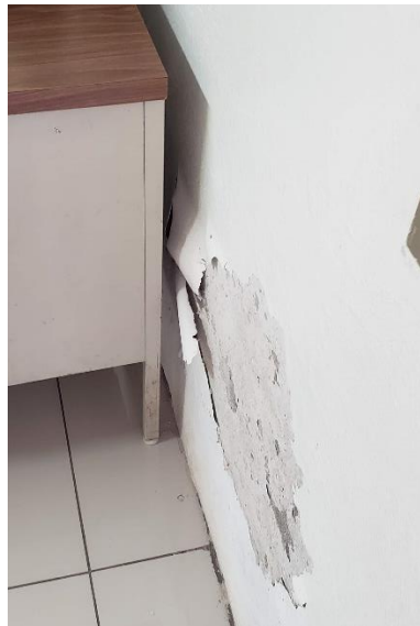
Ilustración 47. Paredes internas con pintura deteriorada.
