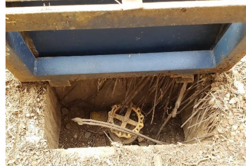
Ilustración 18. Caja de registro de acometida principal con suciedad.
