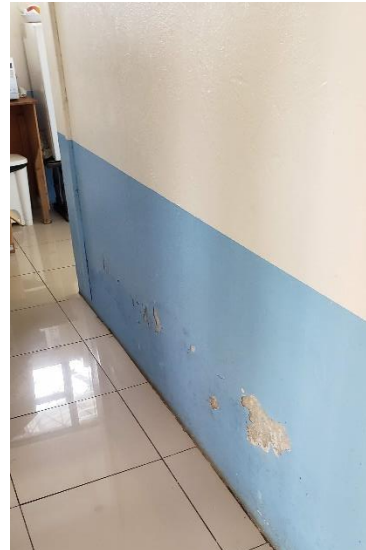
Ilustración 48. Paredes internas con pintura deteriorada.
