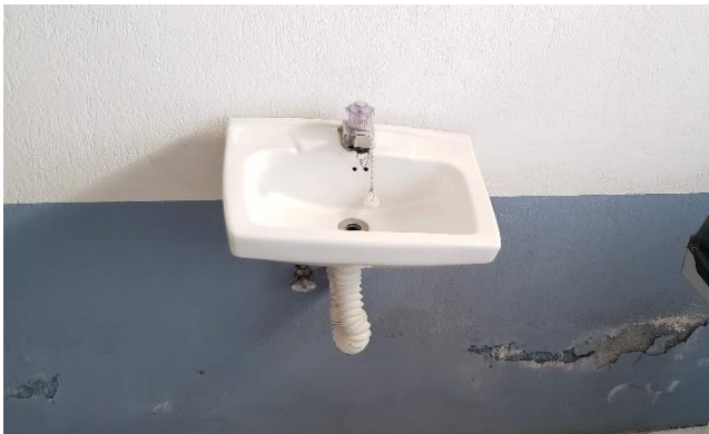
Ilustración 29. Pared con pintura dañada. Lavatorio inclinado.
