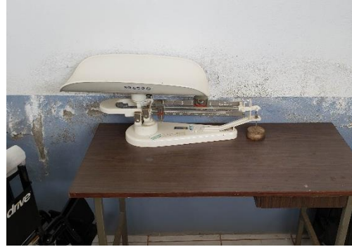
Ilustración 28. Pintura pared interior dañada. Balanza con herrumbre.
