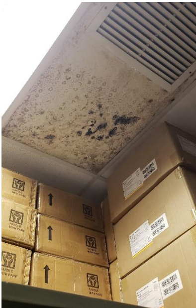
Ilustración 7. Láminas de cielo raso manchadas por humedad.
