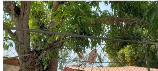
Ilustración 26. Alambre navaja del cierre perimetral dañado.
