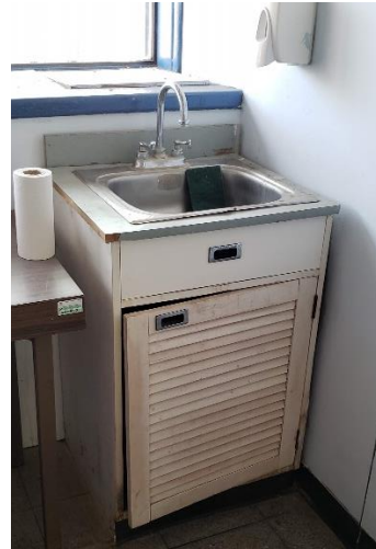
Ilustración 36. Mueble de fregadero en consultorio deteriorado.
