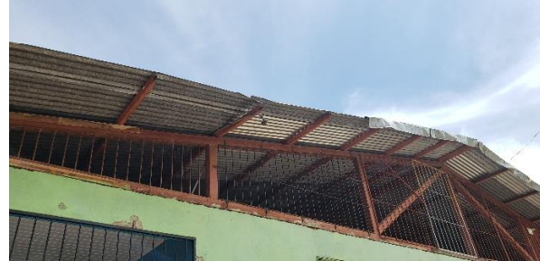
Ilustración 32. Accesos en tapichel y láminas de techos desprendidas.
