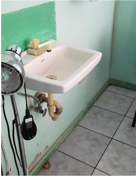
Ilustración 31. Pintura de pared deteriorada. Tubería mecánica de lavatorio deteriorada.
