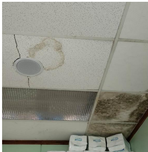
Ilustración 16. Cielo raso deteriorado. Consultorio 2 enfermería.
