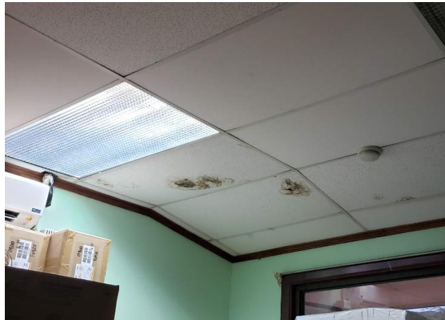
Ilustración 8. Láminas de cielo raso manchadas por humedad.
