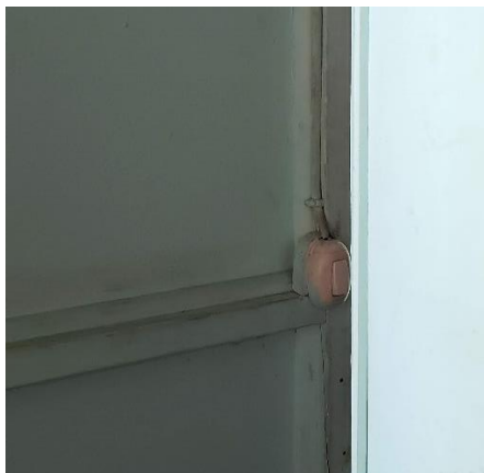
Ilustración 33. Cableado eléctrico sin tubería en paredes de madera.
