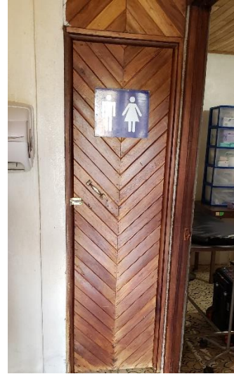
Ilustración 40. Puertas de baño a usuarios de 70 cm de ancho. No cumple con Ley 7600.
