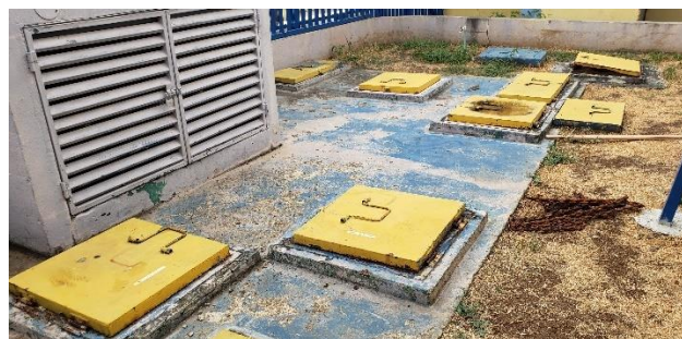
Ilustración 14. Planta de tratamiento con elementos deteriorados y con malos olores.
