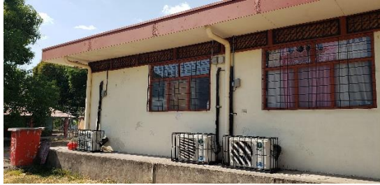
Ilustración 23. Paredes exteriores con pintura deteriorada.
