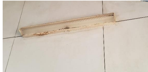
Ilustración 38. Luminaria con herrumbre.
