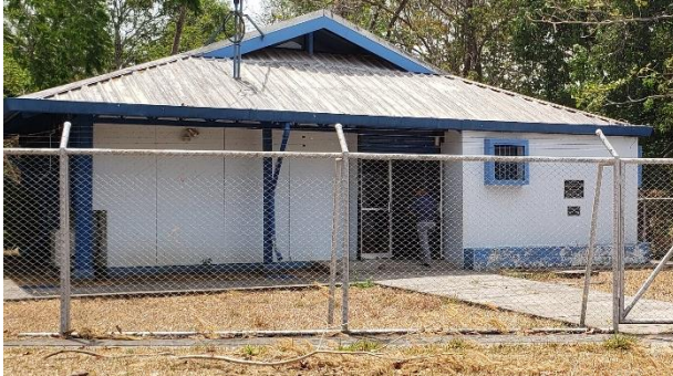
Ilustración 37. Pintura paredes exteriores deterioradas.
