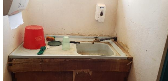
Ilustración 20. Mueble de fregadero deteriorado.
