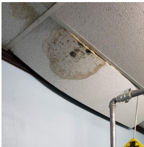
Ilustración 13. Mal estado de cielo raso. Baño Laboratorio.
