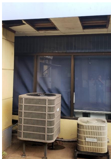
Ilustración 15. Falta de cielo raso en alero. Exterior de Salón multiuso.
