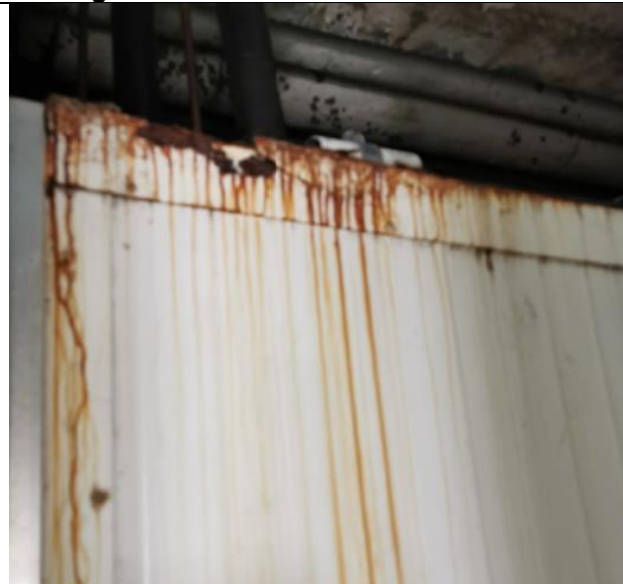
Cuarto frío área externa (acercamiento)
