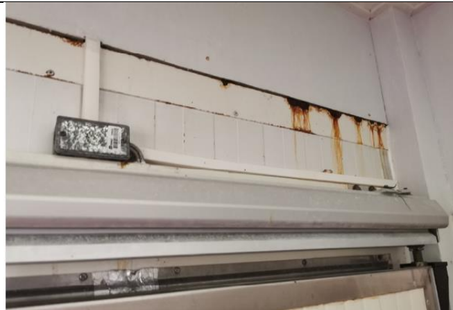
Cuarto frío puerta
