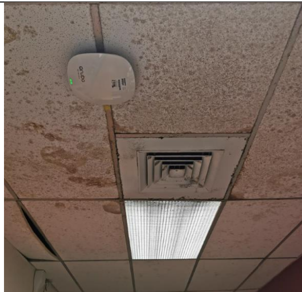
Condición láminas de cieloraso
