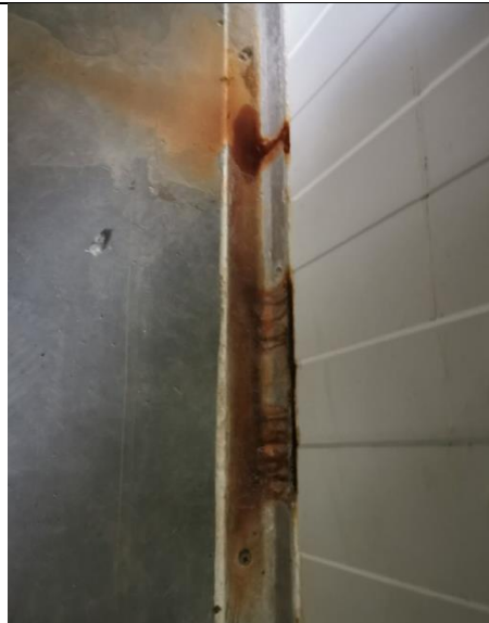
Cuarto frío área interna
