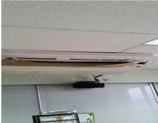
Aire acondicionado de la farmacia satélite del 6° piso
