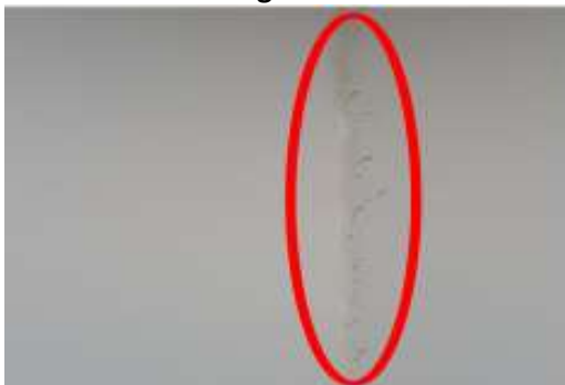
Grietas en las paredes
