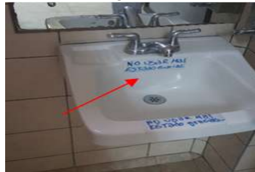
Lavamanos fuera de uso.
