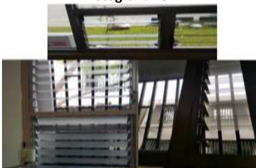
Faltante de celosías y mecanismo de abrir y cerrar dañados.
