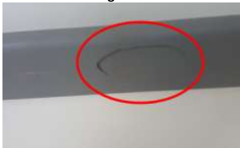
Bumper protector de paredes fisurado.
