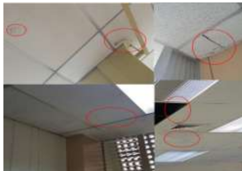
Afectaciones en el cielo raso.
