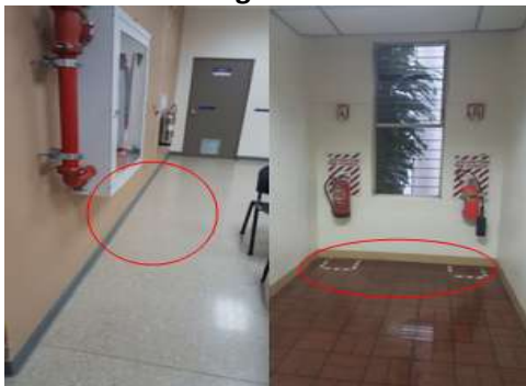
Obstáculos en los pasillos
