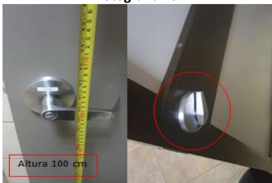
Cerraduras. Bloque A no son de palanca y bloque b supera la altura máxima.
