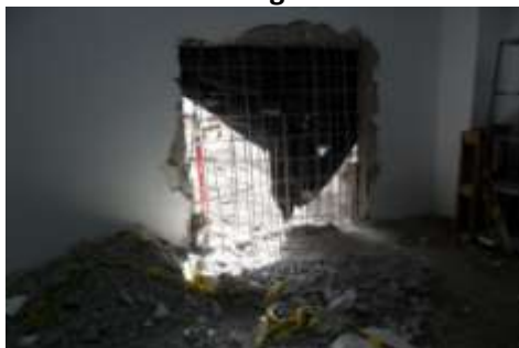
Boquete en la pared de la bodega
