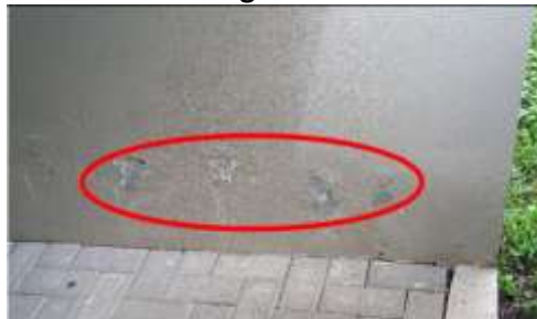
Marcas de humedad en paredes exteriores
