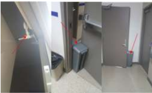
Mecanismos de cierre de puertas dañados o mal utilizados.
