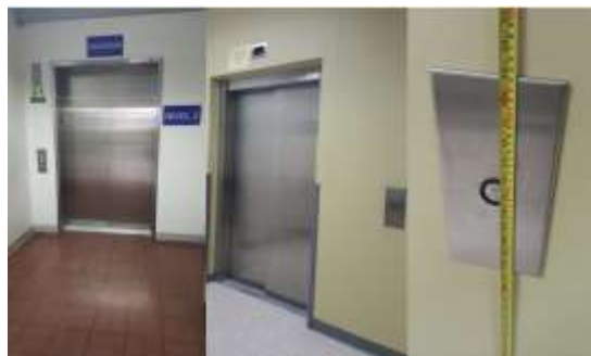
Ascensores sin elementos suficientes para ser accesibles
