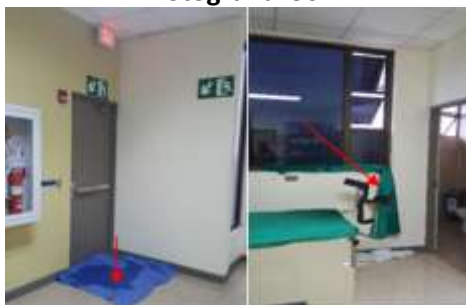
Goteras que afectan el cielo raso.
