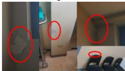
Daños en las paredes por roce de sillas y humedad.
