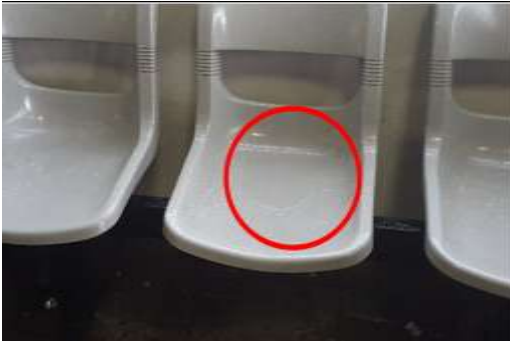
Sillas mojadas por goteras
