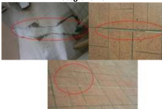
Pisos con sisas sin relleno o parches.
