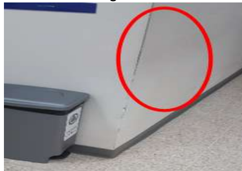
Daños en paredes
