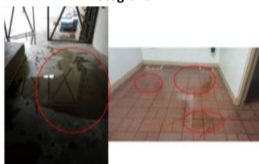
Problemas con acumulación de agua
