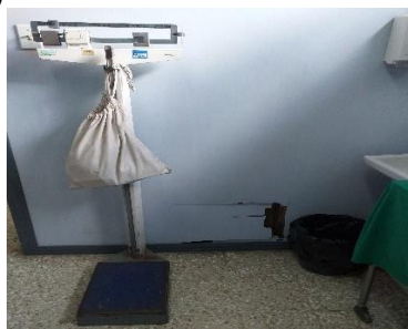
Imagen 2. Huevo en la pared y lavatorio goteando.
