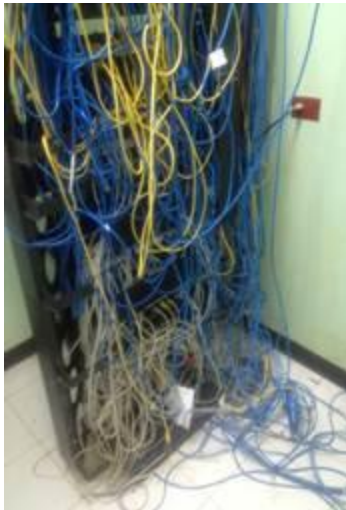
Fotografía 1: Etiquetado de cables
