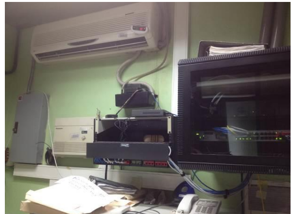
Imagen 7. Servidor y equipo de telecomunicaciones
