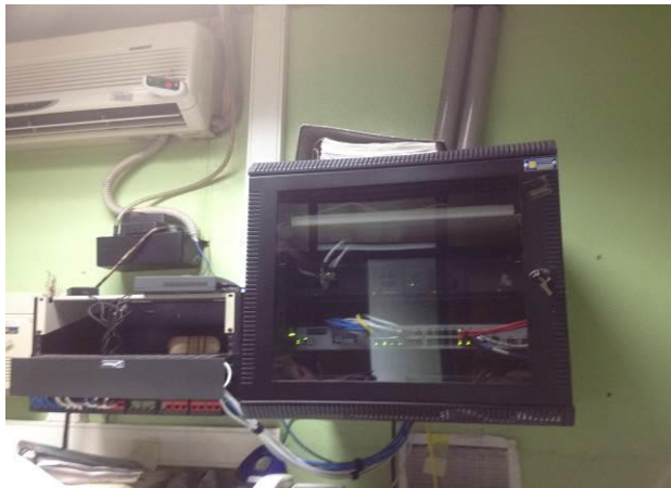
Imagen 6. Rack aéreo con llaves
