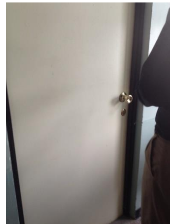
Fotografía 4: Puerta de Acceso Cuarto de Telecomunicaciones
