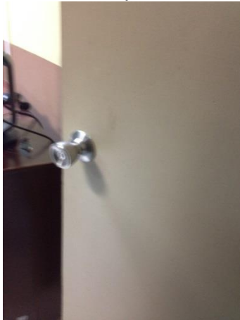
Fotografía 1: Puerta de acceso Cuarto Principal de Datos
