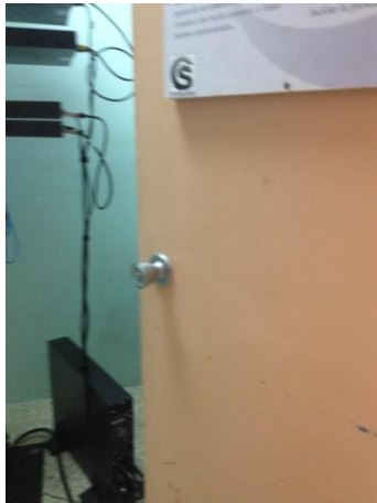
Fotografía 5: Puerta de Acceso Cuarto de Telecomunicaciones
