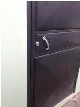
Fotografía 3: Puerta de Acceso Cuarto de Telecomunicaciones
