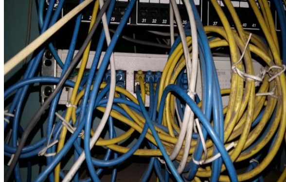
Fotografía 2: Switch de comunicaciones sin puertos disponibles para nuevas conexiones.
