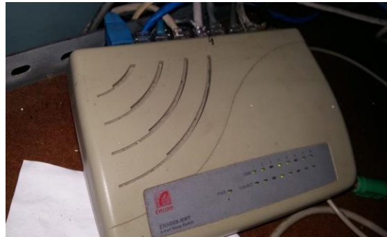
Fotografía 4: Conmutador de red del cuarto de comunicaciones sin puertos disponibles para nuevas conexiones.
