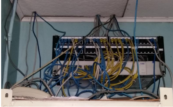
Fotografía 1: Cables de red del cuarto principal de telecomunicaciones
