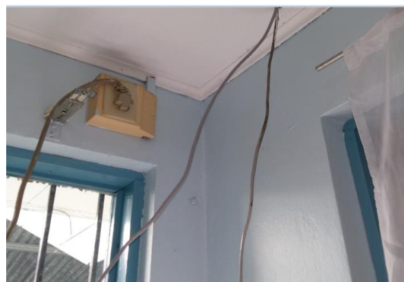
Fotografía 6: Cables de red expuestos y sin canaleta.
