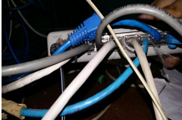
Fotografía 7: Hub del cuarto de servidores.
