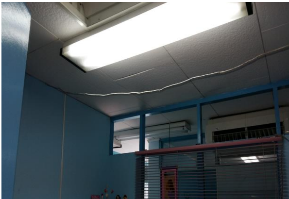
Fotografía 5: Cables de red suspendido en el aire y atravesando oficina.
