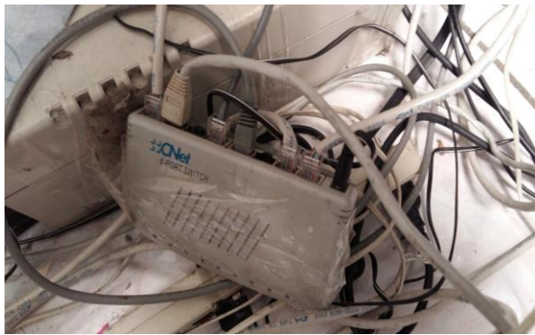
Fotografía 3: Conmutador de red ubicado en el suelo y sellado con cinta adhesiva.
