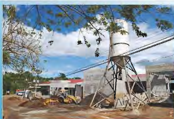
El CAIS de Puriscal ha sido una de las obras que estuvo realizando la CCSS durante el 2008. Este centro se entregará con llave en mano, por lo que la Institución invertirá $ 1.058.610.959 en equipamiento.
